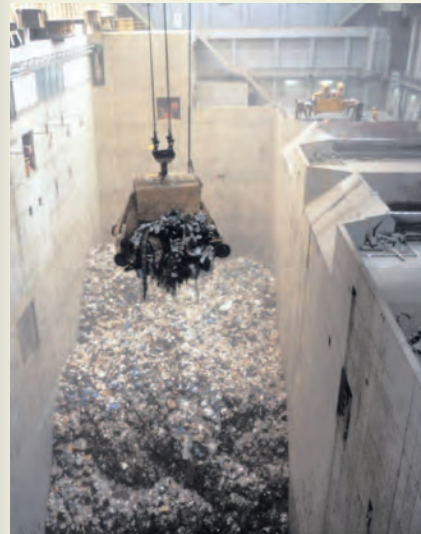
②ごみピット ④ごみクレーン ごみピット容量約11,000m 3 1回のごみクレーンつかみ量約4t A 4 ton crane grabs waste from a 11,000m 3 pit.
