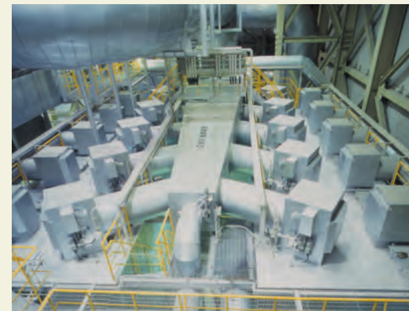
⑮ろ過式集じん装置 排ガス中のばいじんを除去し、排ガスを浄化します。 A bagfilter captures fly ash and dioxins from exhaust gas in order to clean it before release.
