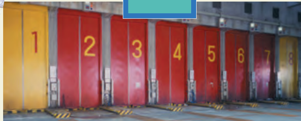
①ごみ投入扉 収集したごみは8面の投入扉からごみピットに投入されます。 The waste transported to the plant is dumped into the waste pit from the 8 waste pit door.
