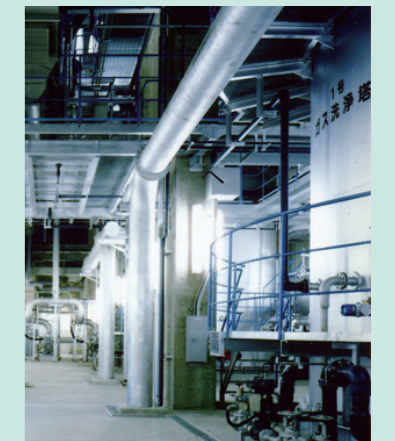
⑰排ガス洗浄装置…排ガス中の塩化水素等を洗浄処理します。
