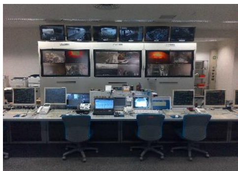
〈中央制御室 運転・監視〉
