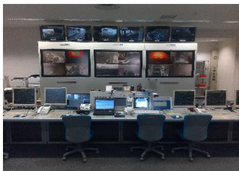
〈中央制御室 運転・監視〉
