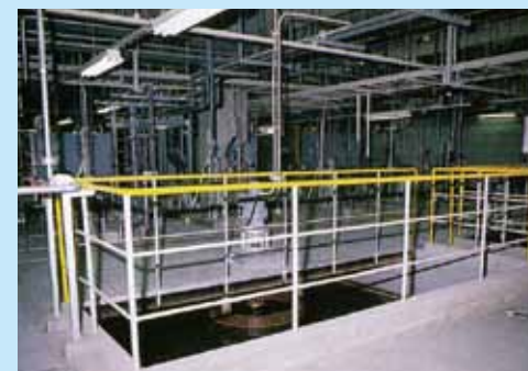
排水処理設備…工場内の排水を凝集沈澱・ろ過吸着処理した後、公共下水道へ放流します。
