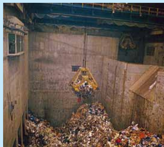
ごみピット・ごみクレーン…ごみピット容量約8,000m 3 (約2,400t) ごみクレーンつかみ量1回10m 3 (約5t)
