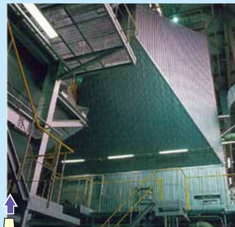
電気集じん器…排ガス中のばいじんを除去します。
