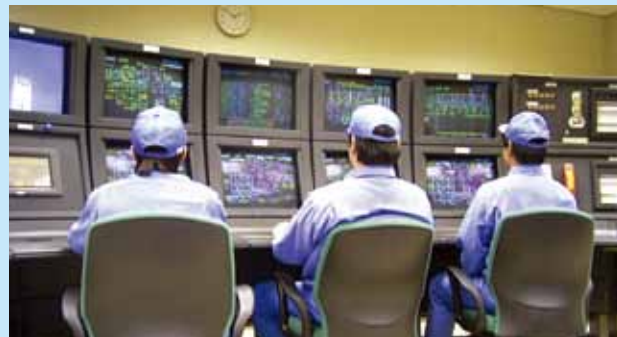
中央制御室…工場全体の稼動状態を常に監視し、集中操作します。
