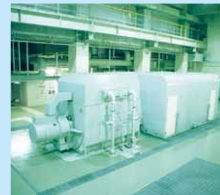
発電機…焼却炉の余熱ボイラで発生した蒸気により発電します。出力11,000kw
