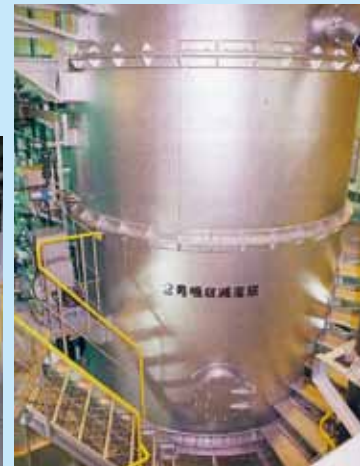
排ガス洗浄装置…排ガスを洗浄処理します。
