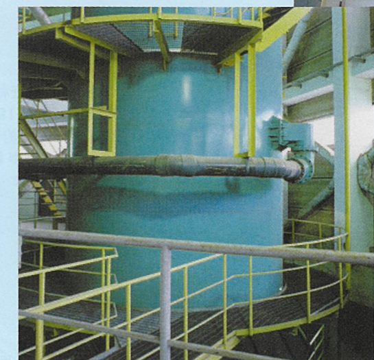
排ガス洗浄装置…排ガス中の塩化水素等を洗浄処理します。
