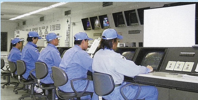
中央制御室…工場全体の状態を常に監視し、集中操作します。
