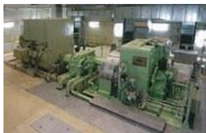
発電設備（東淀工場）
