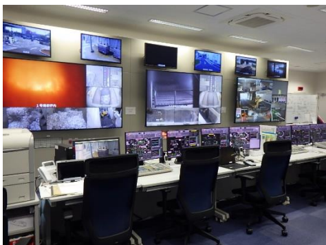
〈中央制御室 運転・監視〉
