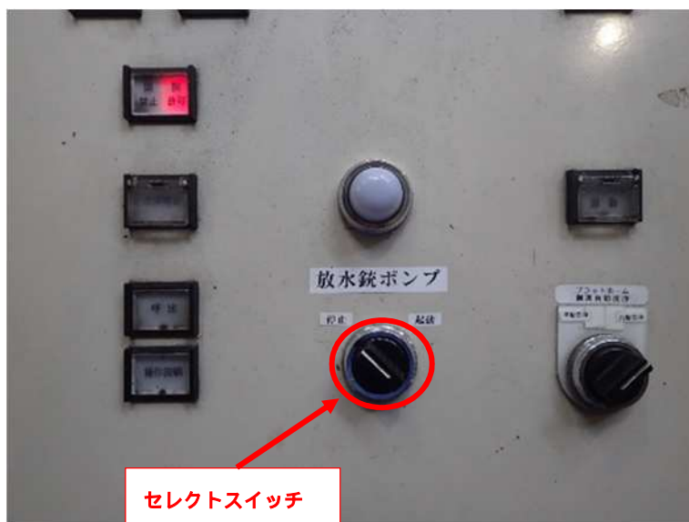
写真 - 2 1 F 操作盤のセレクトスイッチ
