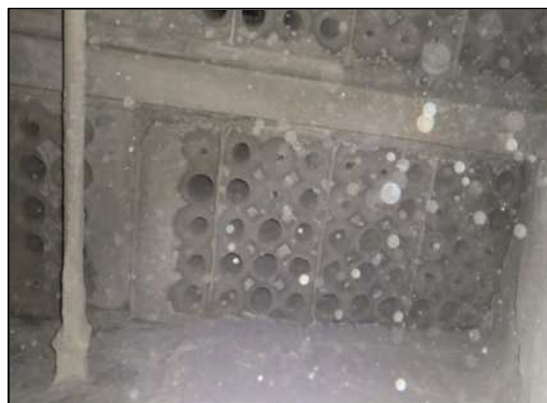
写真 - 2 ろ布詰まり状況
