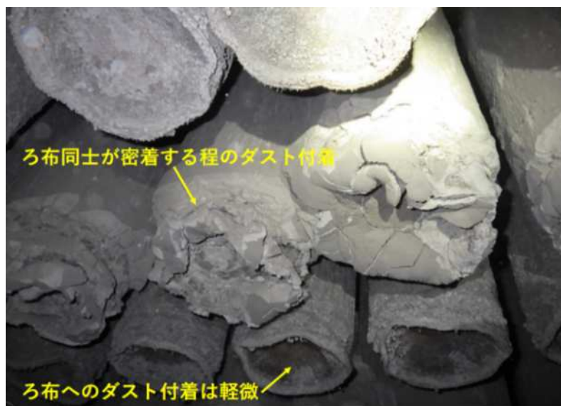
写真 - 1 バグフィルターろ布のダスト付着状況
