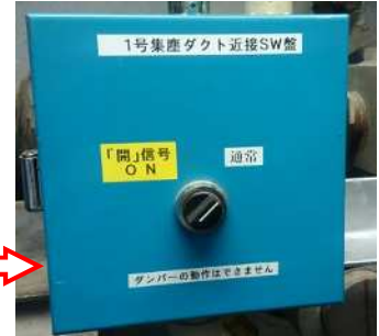
写真 - 7 近接SW制御盤
