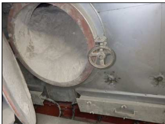
写真 - 1 下部シュート詰まり状況
