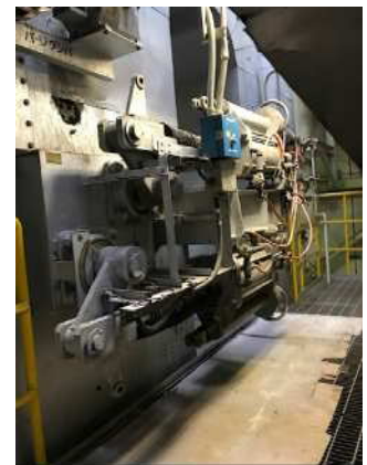
写真 - 1 集塵装置入口ダンパ
