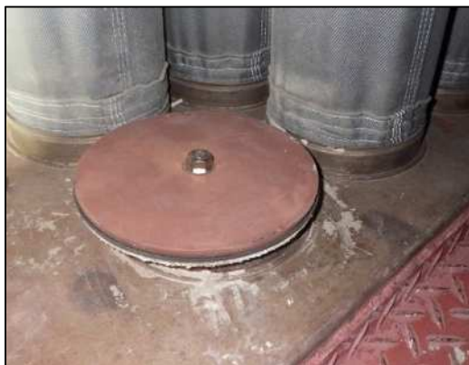
写真 - 3 ろ過式集じん器点検蓋
