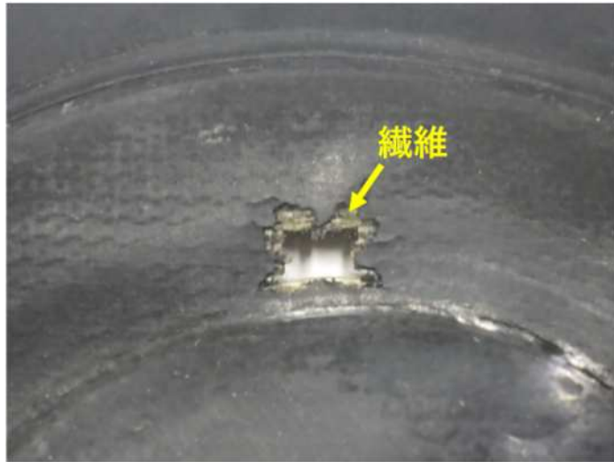
写真 - 4 損傷ダイヤフラム拡大図
