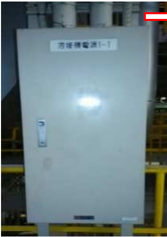
写真 - 5 溶接電源盤
