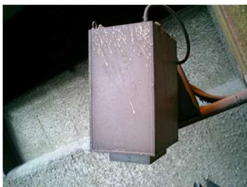
写真 2 熱感知器（4台設置）
