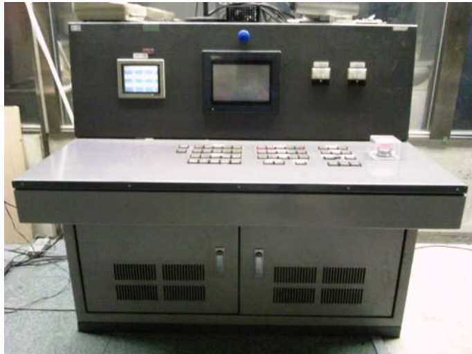
写真 - 2 プラットホーム制御盤
