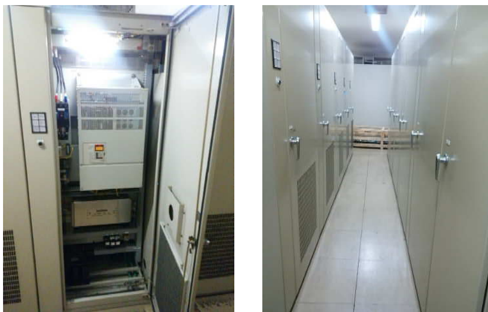
写真 - 1 タービン復水器用インバータ配電盤内取付状態及び配電盤配置状況
