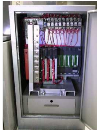
写真 - 8 制御盤 (箱入)
