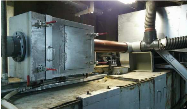
写真 - 12 フィルターボックスの外観
