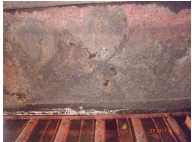
写真 - 3 ひび割れの様子
