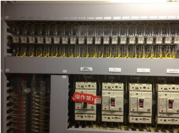
写真 - 3 動力盤内の様子
