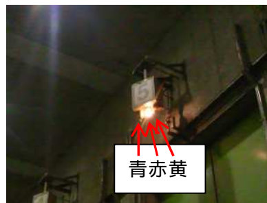
扉番号（前）表示灯
