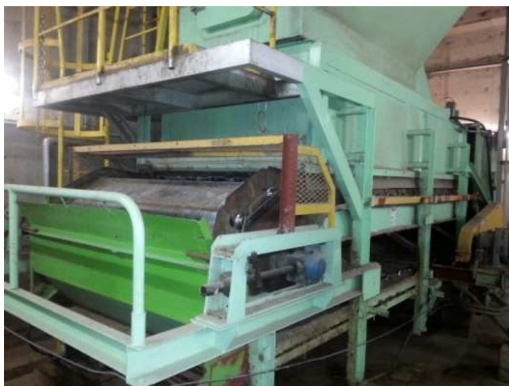
写真 - 1 No. 1 低速搬送コンベア
