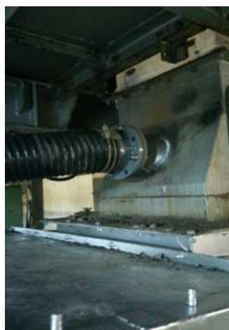
写真 - 10 混練機出口
